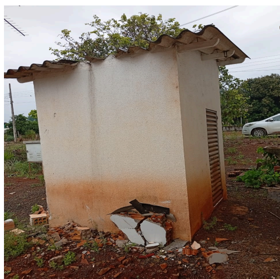
Imagem 36: local de armazenamento de RSS com problemas de infraestrutura
